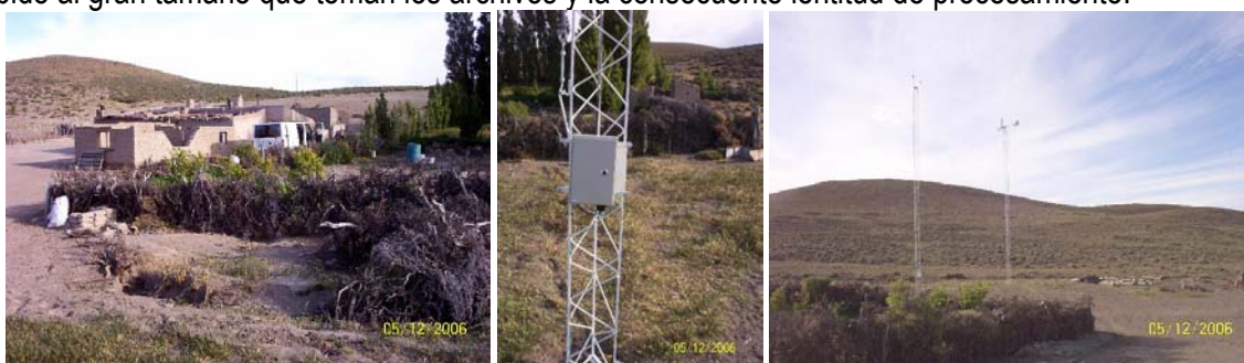
Figura 3.5 – Instalación sistema 8 Hermanos día 5-12-06 (Pocitos de Quichaura)
