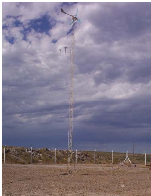
Figura 2.3 – Molino Aerowind de 800W , con sensores, instalado en Aerowind – Puerto Madryn (Mayo 2006)
