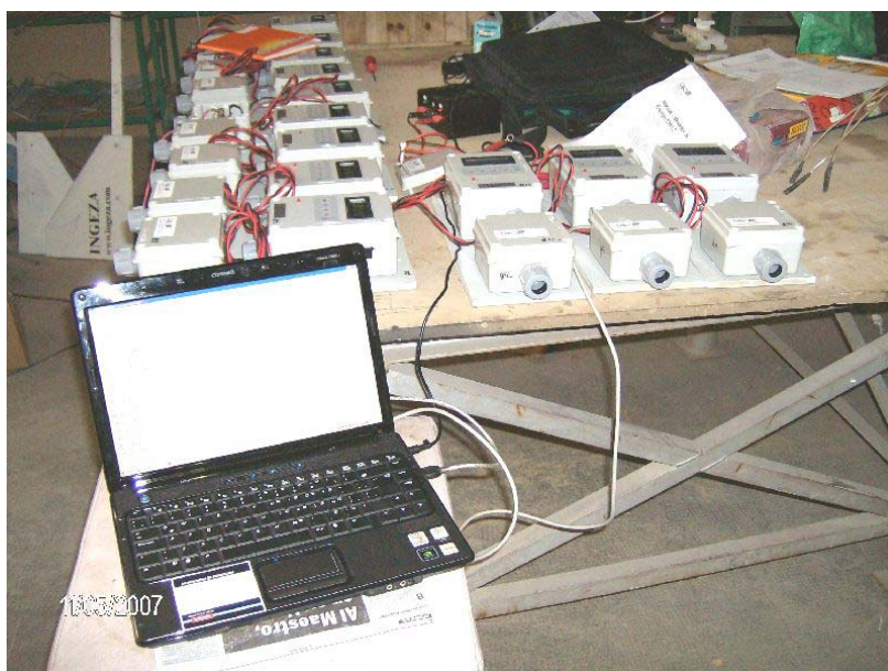
Figura 5.6 - Configuración y verificación medidores de energía EM/12 entregados 11-05-2007
