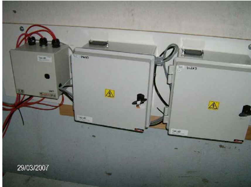
Figura 5.3 - Vista instalación interior en Flia Huenelaf – 29-3-07
