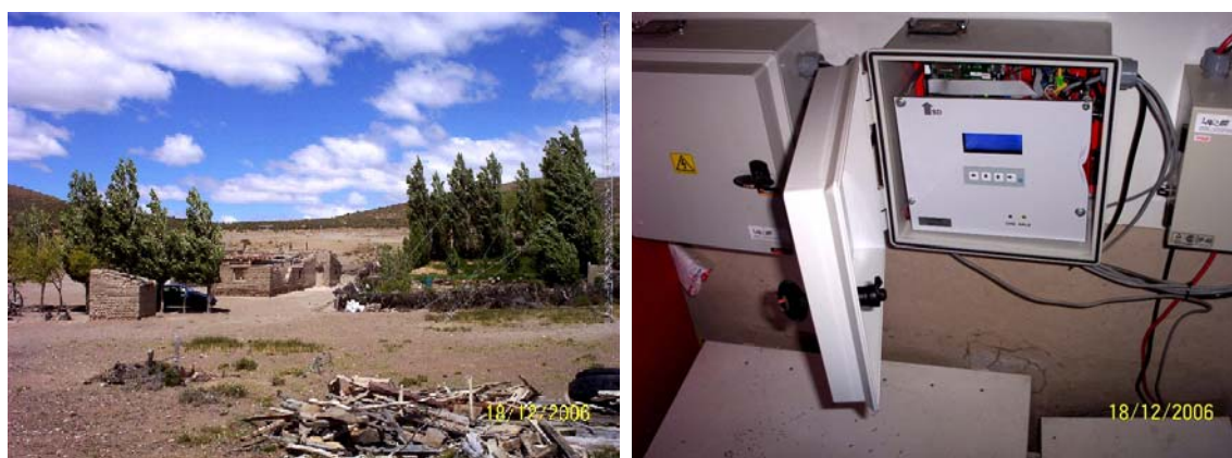
Figura 3.7 – Visita de control en Establecim. 8 Hermanos 18/12/2006 (izq) y equipos PWRC+DL2 en interior (der.)
