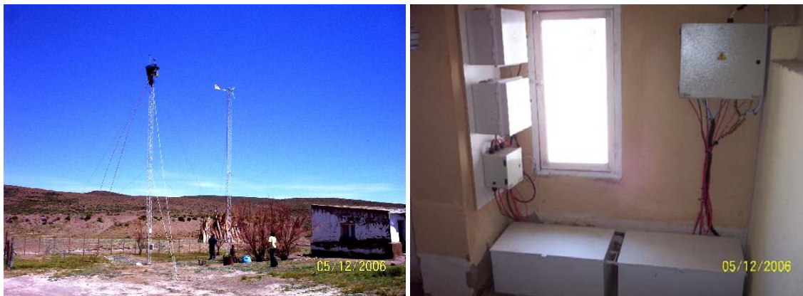
Figura 3.4 – Instalación sensores exterior, y sistema finalmente instalado día 5-12-06 (en Pbro.García /Pocitos de Quichaura)
