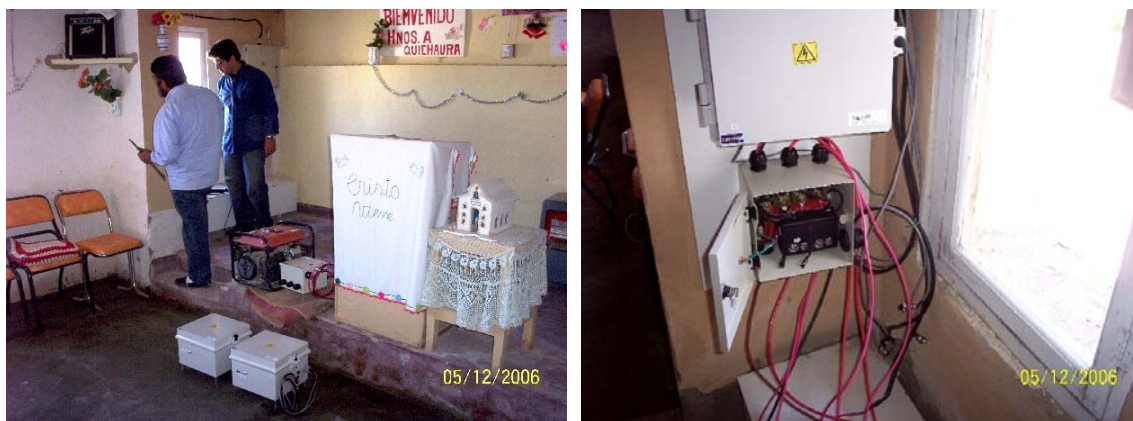
Figura 3.3 – Proceso de Instalación de primer juego de equipos PWRC – DL2 – METEO (en Pbro. García /Pocitos de Quichaura)
